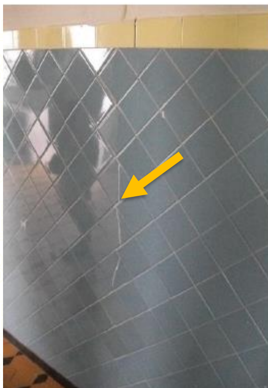
Figura 4 - Fissura em parede com revestimento cerâmico (Fonte: Fotos Pré-Obra)
