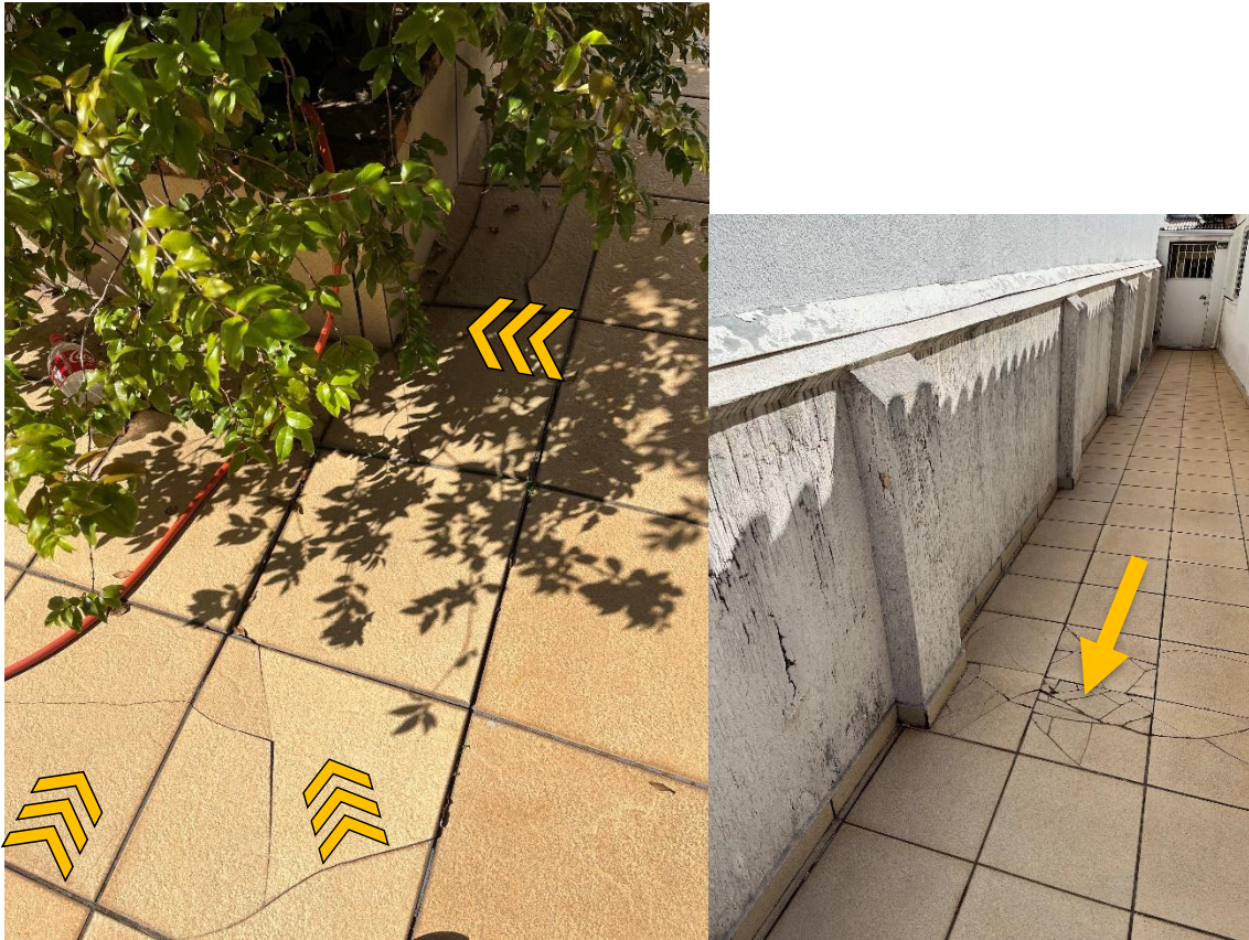
Figura 7 – Afundamento do piso na área externa (Fonte: Visita Técnica)
