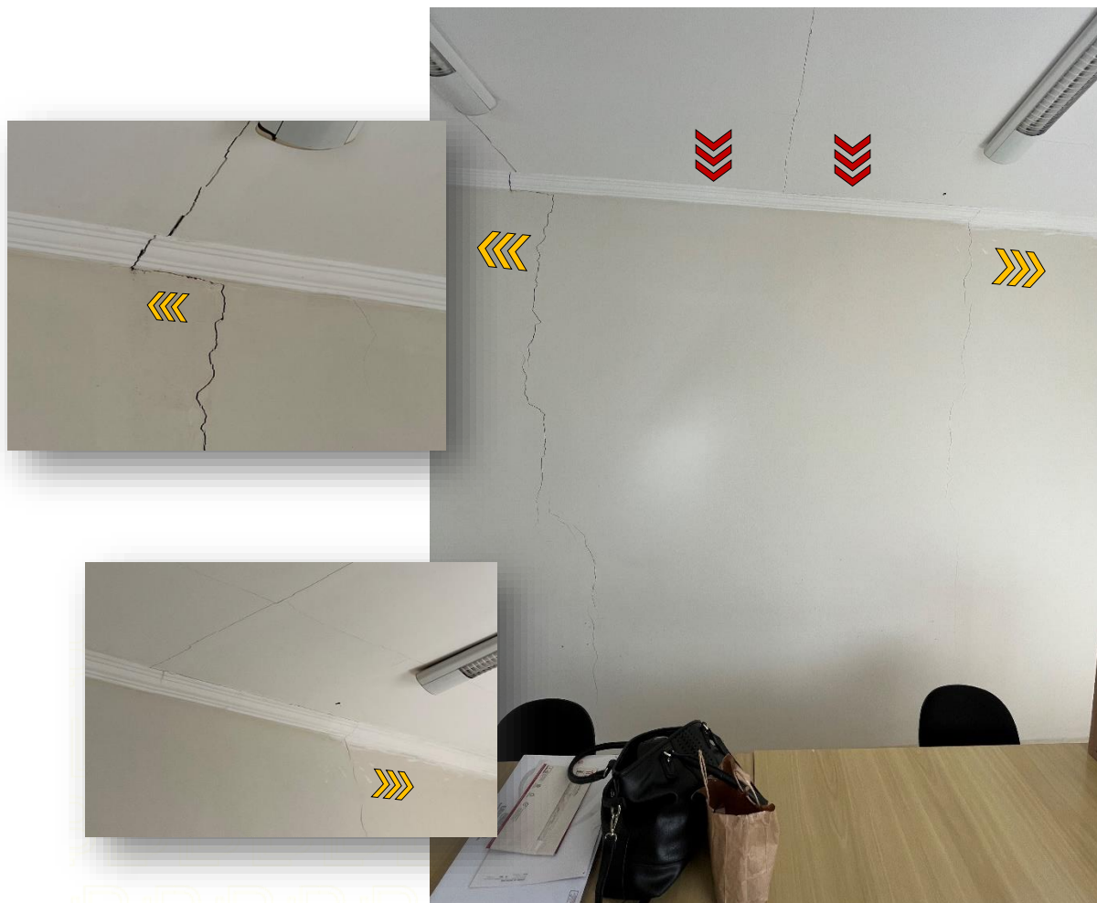
Figura 10 - Trincas na parede interna da Sala de Reunião
